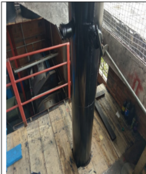
FOTOGRAFÍA No 1 PUERTOS Y PLATAFORMA DE MUESTREO EN EL DUCTO DE LA CALDERA
